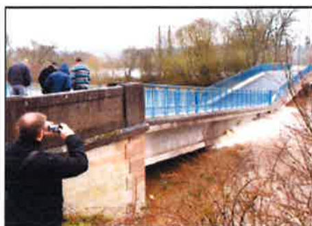
Le pont de Bainville-aux-Miroirs, sur la Moselle, n'a pas résisté aux intempéries.
